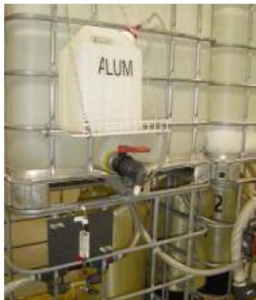
Figura 4: Tanque alimentador de aluminio concentrado y soporte de tanque
